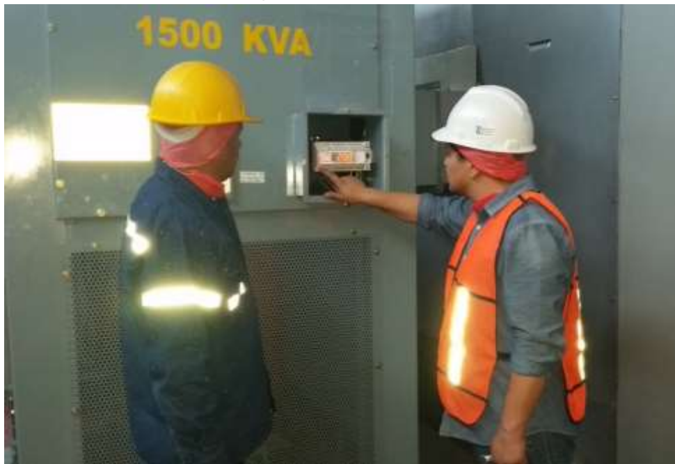
Calibración de Control de Temperatura. Foto TR 1500 KVA Instalado en Bimbo GDL.
